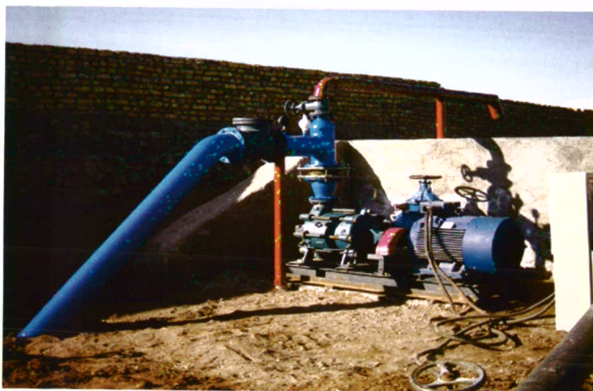
شکل ۶: سیستم پمپاژ در آبیاری قطره‌ای
